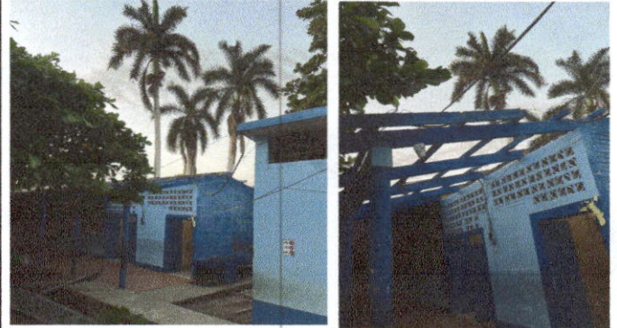
Foto 2: Mantenimiento a estructura de soporte de madera (pintura) en módulo de baños.
