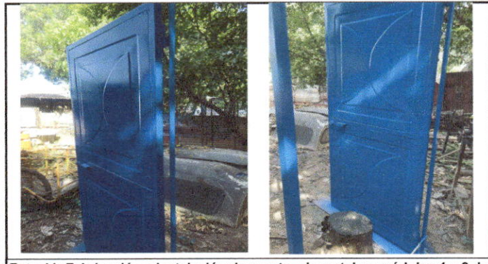
Foto 11: Fabricación e instalación de puertas de metal en módulos 1 y 2 de aulas.
