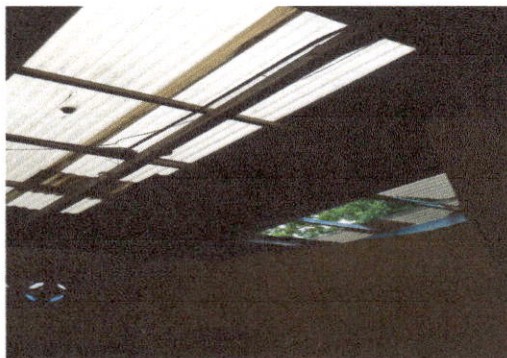
Foto 3: Sustitución de lámina acanalada, por lámina troquelada aluzinc calibre 26 en módulo de baños.
